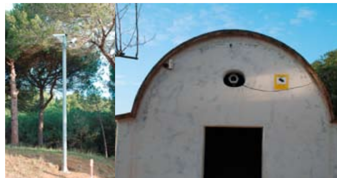
Instal·lació de càmeres de video-vigilància a l'entrada
